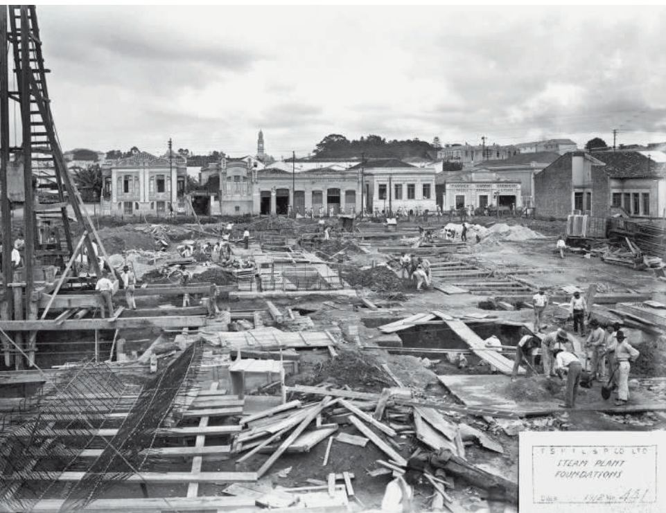
Obras no conjunto da subestação Paula Souza relativas às fundações da usina a vapor de geração de energia. Ao fundo, o casario da rua da Cantareira e a torre da Estação da Luz. Fotografia, Guilherme Gaensly, 1912. Acervo Fundação Energia e Saneamento.
