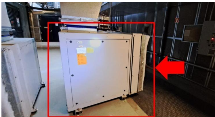
Figura 2 - Equipamento de ar condicionado comandado pelo inversor existente dentro o painel elétrico QF-AC-61.
